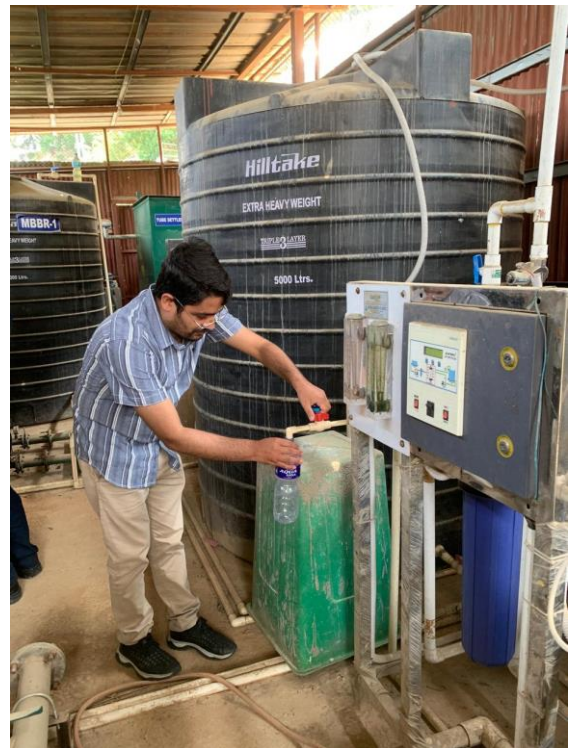
फोटो नं. ८ होटलको waste water treatment plant (मिति २०८२/०९/२९)
