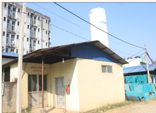
अस्पतालको आफ्नै अक्सिजन उत्पादन गृह (अक्सिजन प्लान्ट)
